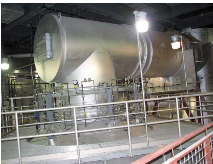
Figura 12. Parte superior de dos hornos con su conducto de salida de gases y sistema de pulverización de agua.
