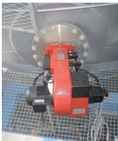
Figura 10. Quemador de seguridad
