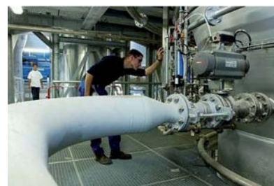
Figura 9: Inyección de lodos en el horno
